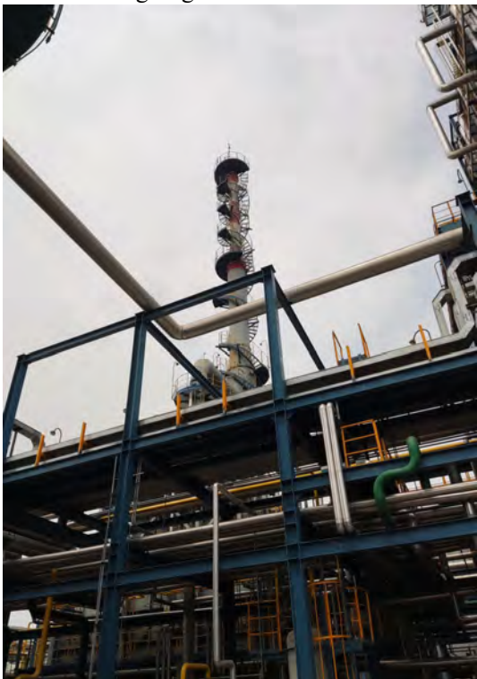
g19加热炉排气筒
