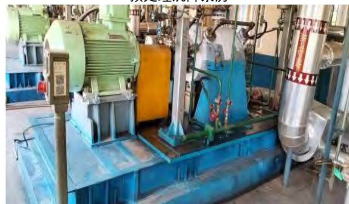
延迟焦化热油泵房
