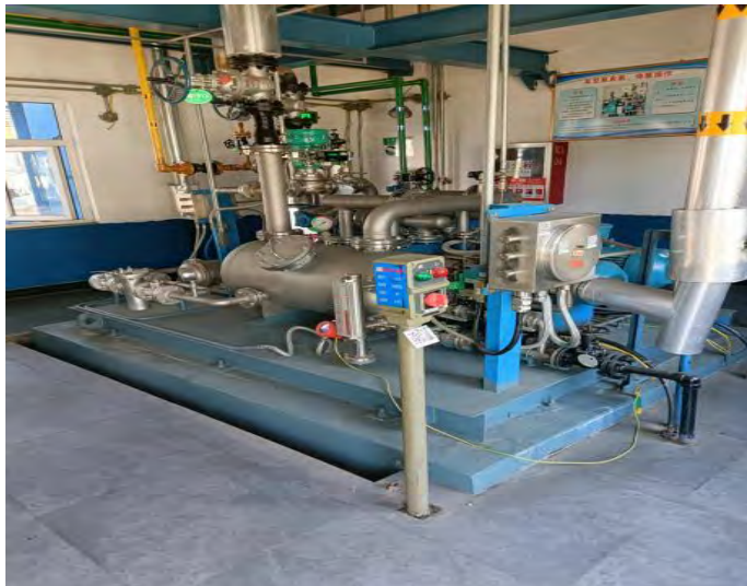
预处理热油泵房
