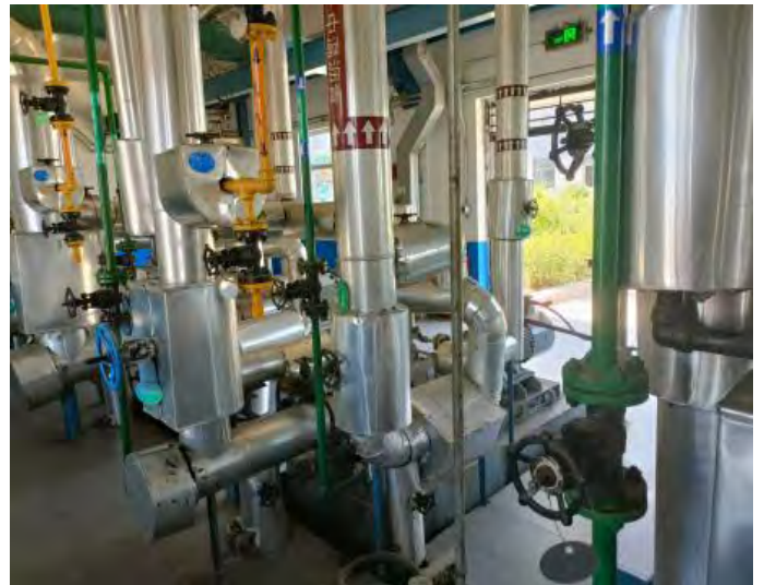
原料预处理热油泵房
