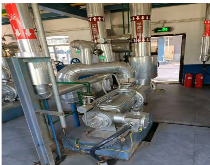
预处理冷油泵房
