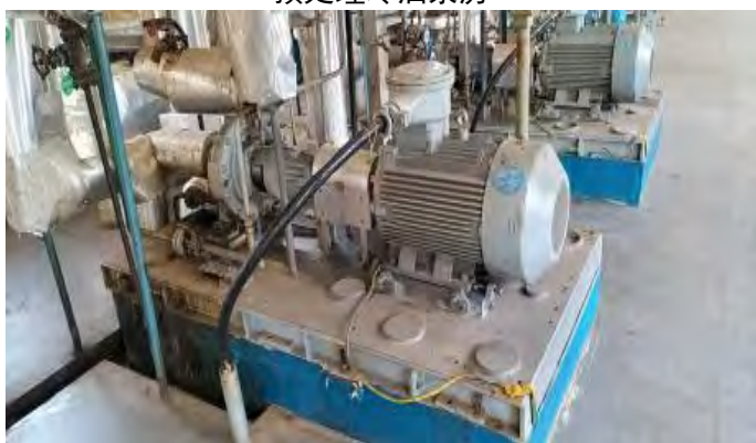
延迟焦化冷油泵房
