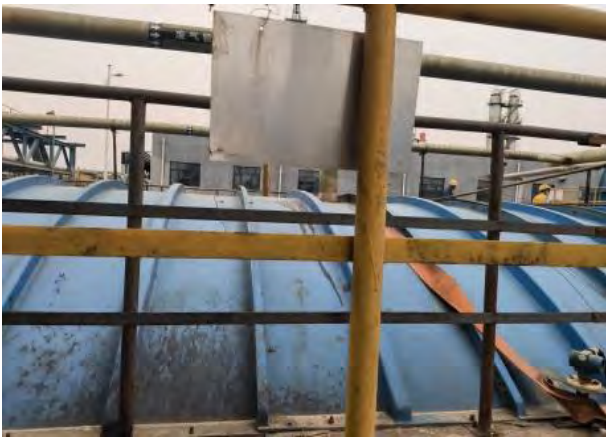
平流式沉淀池
