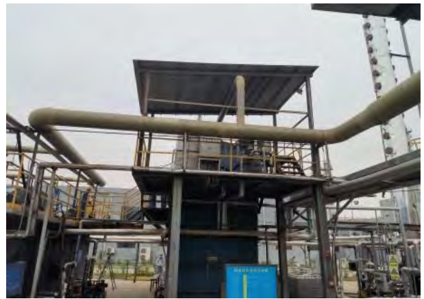
一体化除油装置和混凝沉淀池
